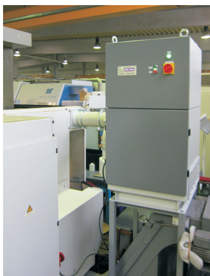
Odsavač v provozu... Aplikace - odsávání emulzní mlhoviny od CNC frézovacího centra
